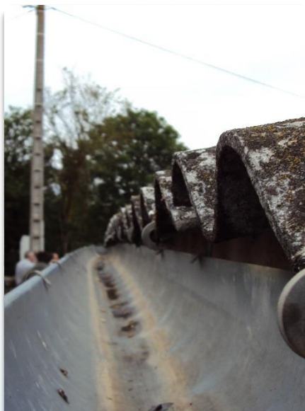
Récupération des eaux pluviales
